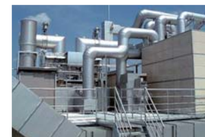
2005年4月に本格稼働した排ガス処理装置
