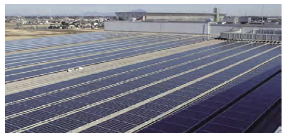
915枚のパネルを設置した五霞工場3号館
