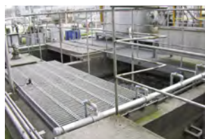
生産排水処理施設
