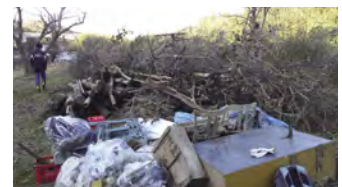
震災で発生したのがれきの撤去
