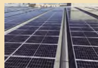
相模原工場に新設した太陽光発電設備
