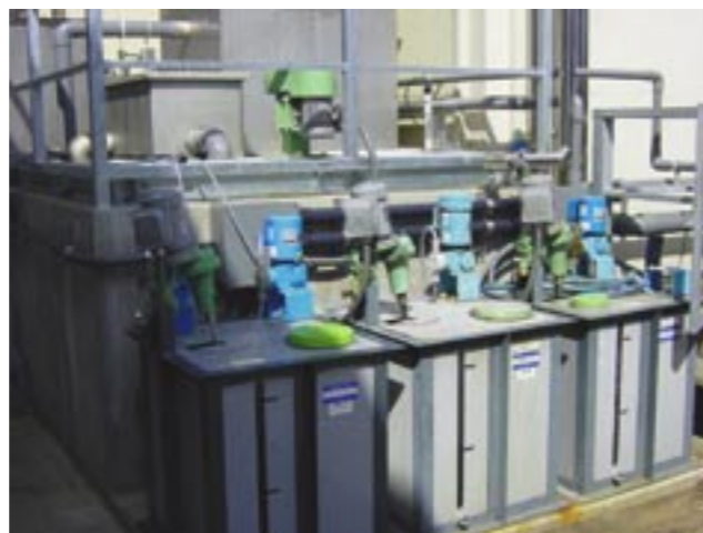
排水処理場（鶴ヶ島工場）
