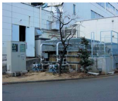
排水処理場（鶴ヶ島工場）
