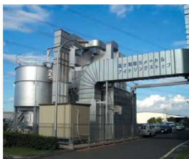
排ガス処理装置（守谷工場）
