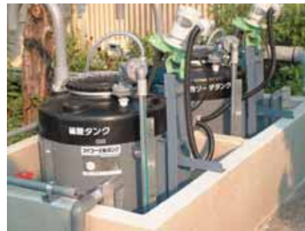
排水処理場中和用薬液タンク(越谷工場)
