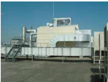
排気ガス処理装置(鶴ヶ島工場)
