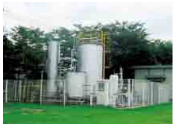
排出処理設備（五霞工場）
