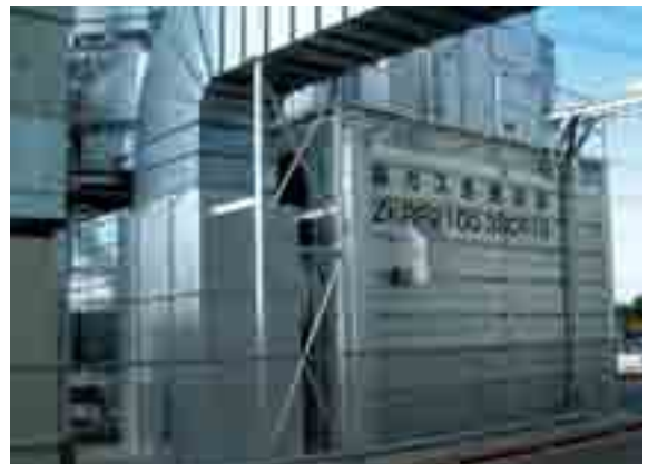
濃縮蓄熱型排ガス処理装置（守谷工場）
