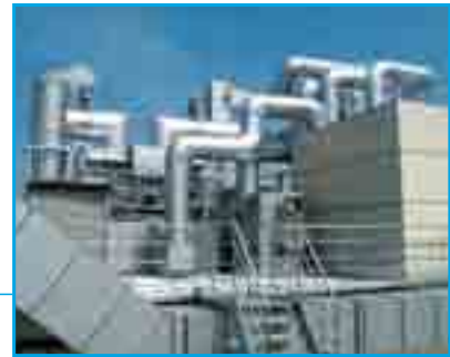
燃焼処理装置(鶴ヶ島工場)
