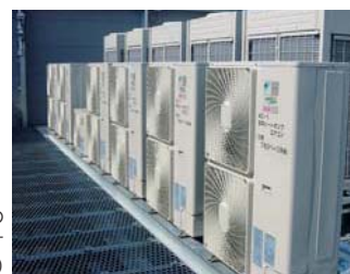
低騒音型空調室外機の四方を壁で囲んでいます (近畿共同印刷)
