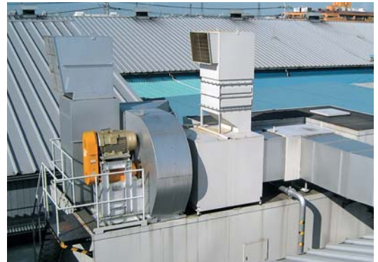
排ガス処理装置 (越谷工場)
