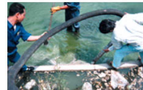
油流出緊急対応（五霞工場）
