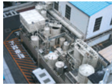
工場排水処理設備（本社事業所）
