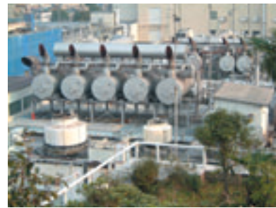
有機溶剤回収装置（本社事業所）
