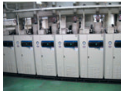
都市ガス焼き省エネ型全自動貫流ボイラー（本社事業所）
