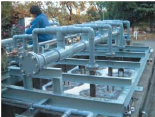
排水処理場（鶴ヶ島工場）
